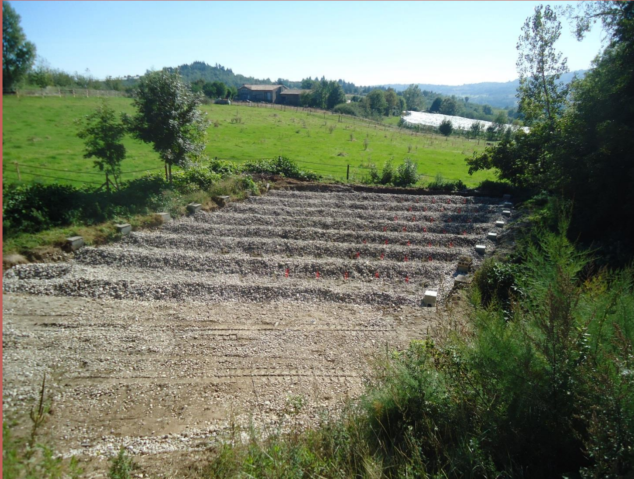
Plantation de roseaux sur le filtre à sable des Andrivaux
